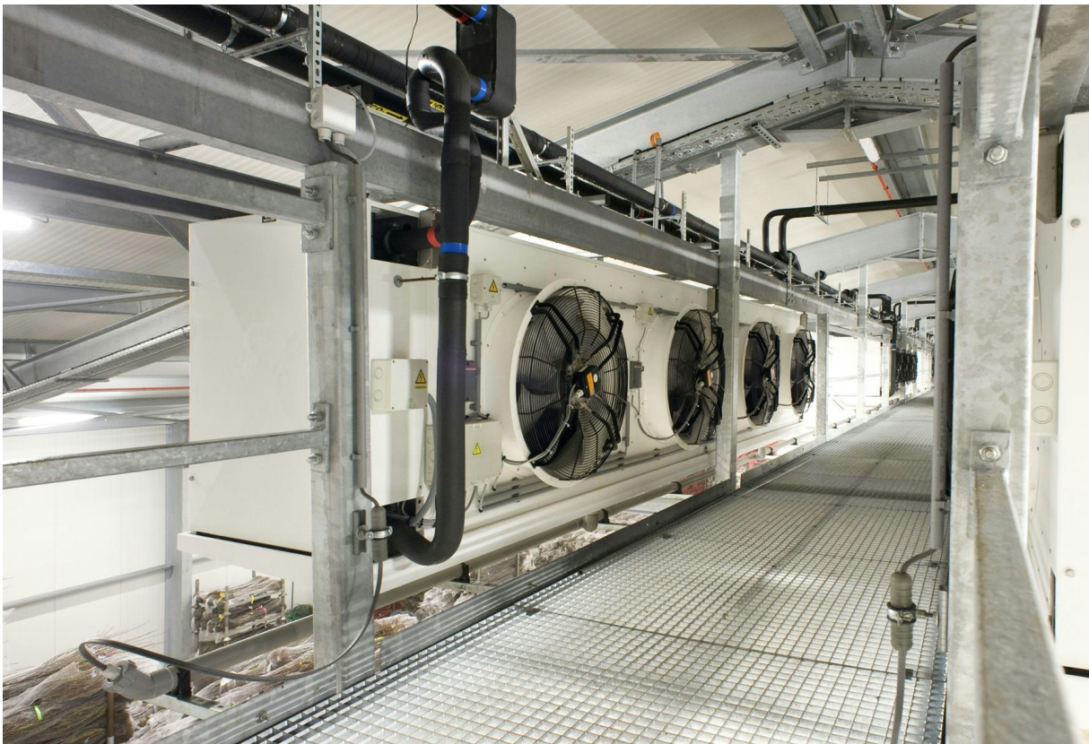
De Kelvion-verdampers in de koelcel zijn goed bereikbaar voor onderhoud.
