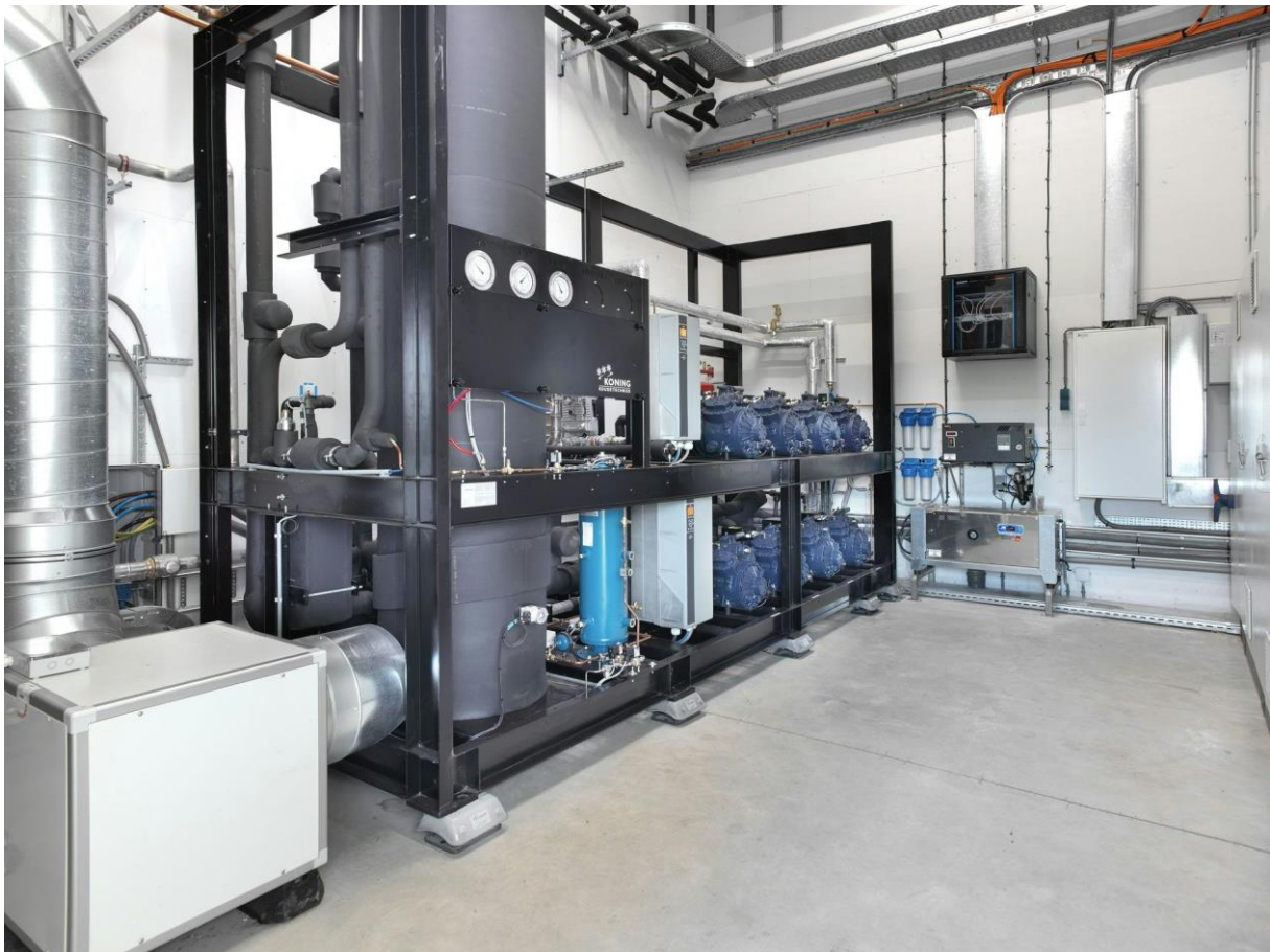
De machinekamer met de CO 2 -installatie, voorzien van acht Dorin-compressoren.
